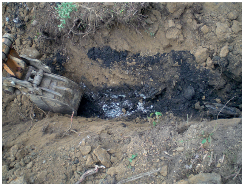
3. Pollution d'hydrocarbures recouverte de remblais © F. Marot
